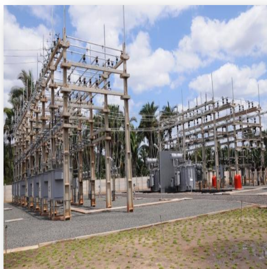
Figura 164 – Subestação Poty localizada na Zona Norte de Teresina Fonte: Eletrobrás Distribuição Piauí, 2013
