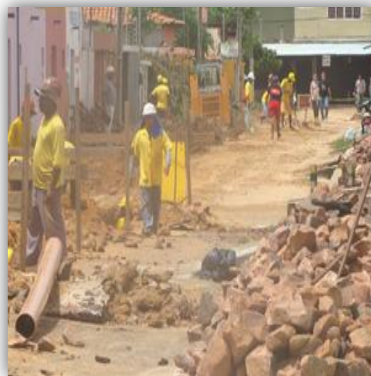
Figura 160 - Esgotamento Sanitário de Timon (MA) Fonte: Prefeitura Municipal de Timon, 2013
