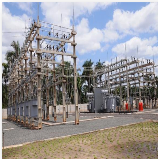
Figura 187 - Subestação Poty, localizada na Zona Norte de Teresina Fonte: Eletrobrás Distribuição Piauí, 2013
