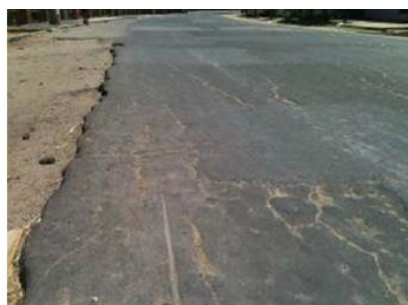
Fissuras no Pavimento.
