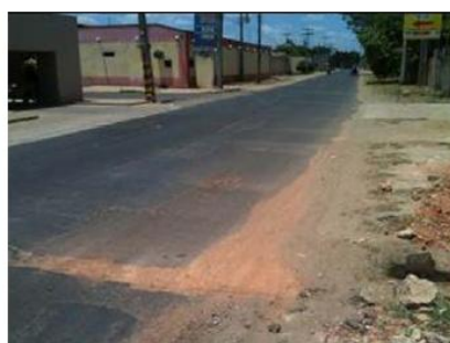
Buracos no Pavimento.
