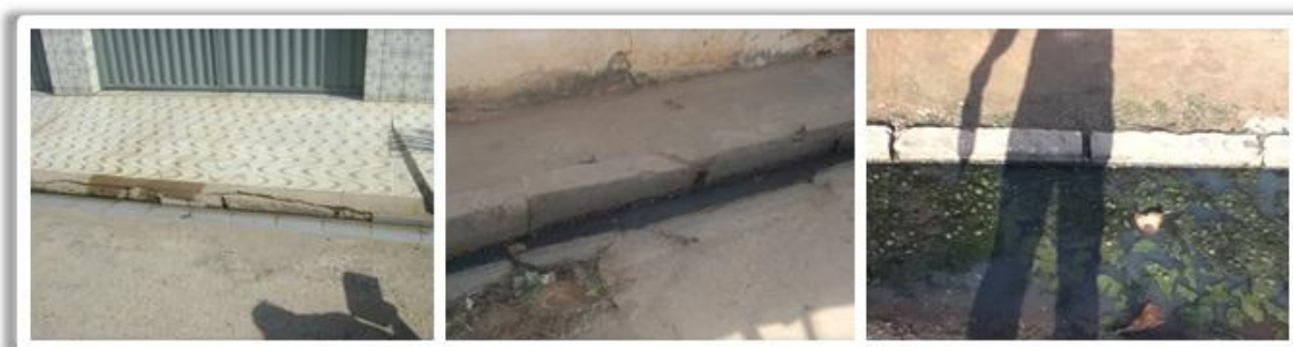
Figura 9. Escorrimentos a céu aberto
