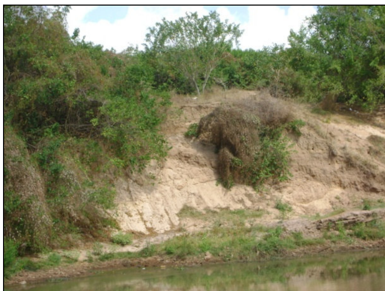
Foto 12 - Erosão da APP no lado Ilhotas. / Fonte: Autores, 2012.
