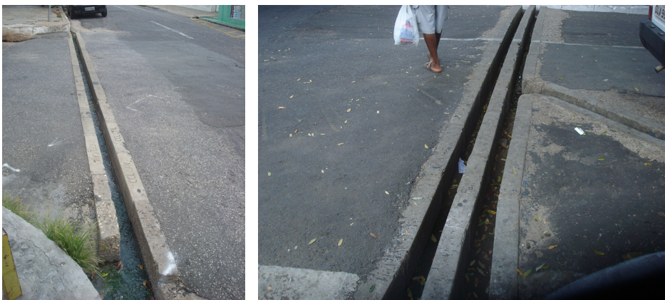
Foto 5: Canaletas de drenagem de águas pluviais muito profundas e sem arremate adequado no encontro com as guias e sarjetas Fonte: TC Urbes, 2014
