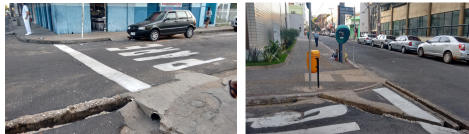
Foto 6: Sistema de drenagem bastante irregular na área central do município Fonte: TC Urbes, 2015
