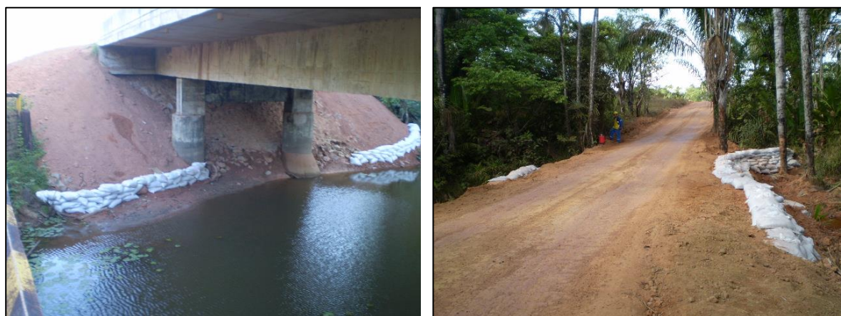
Figura 31: Exemplos de Aplicação de Rip-Rap – cabeceira de bueiro em caminho de serviço; cabeceira de pontes.
