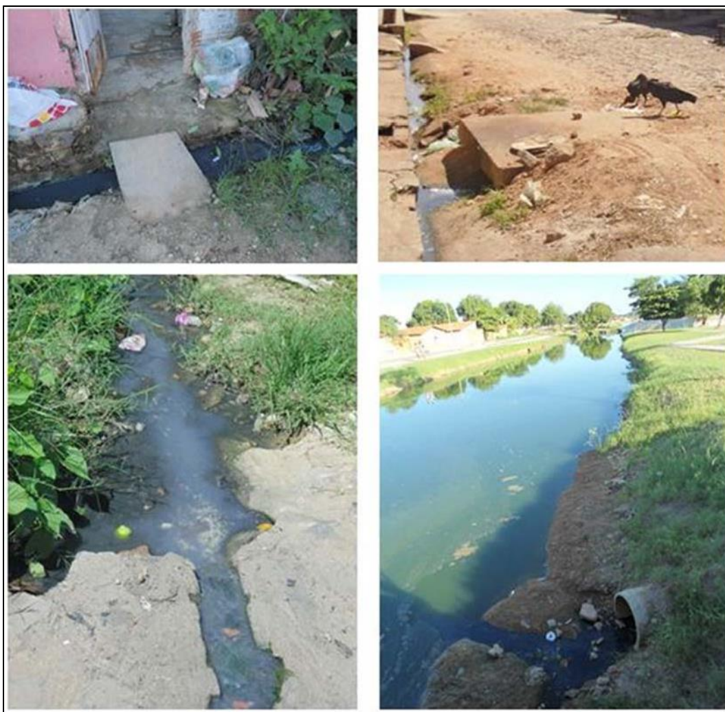
Figura 4. Algumas das deficiências em infraestrutura de saneamento ambiental da região e que impactam de forma direta e negativa na saúde da população.
