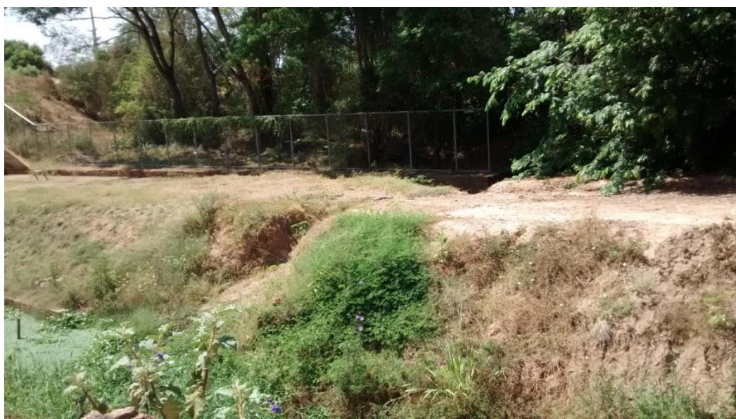
Figura 15: Elevatória dos Oleiros – Canais de descarga / Evidência de falta de limpeza e conservação / Presença de remanescente de mata ciliar.
