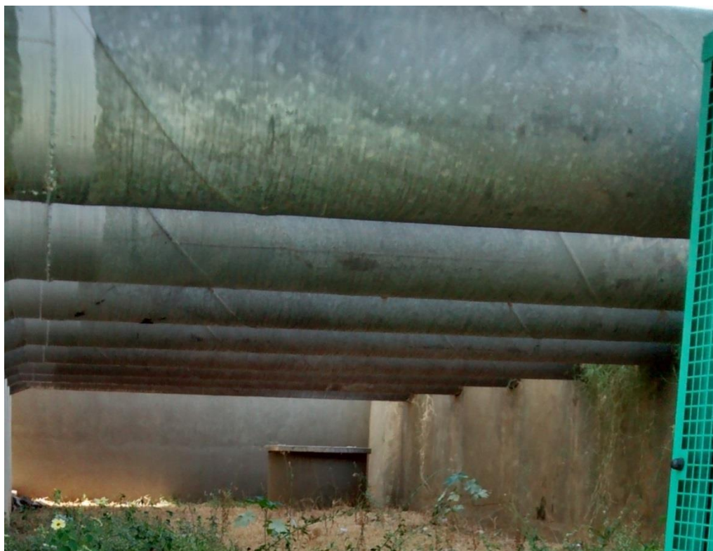
Figura 12: Elevatória dos Oleiros – Tubulações de recalque da ampliação (trecho aéreo).
