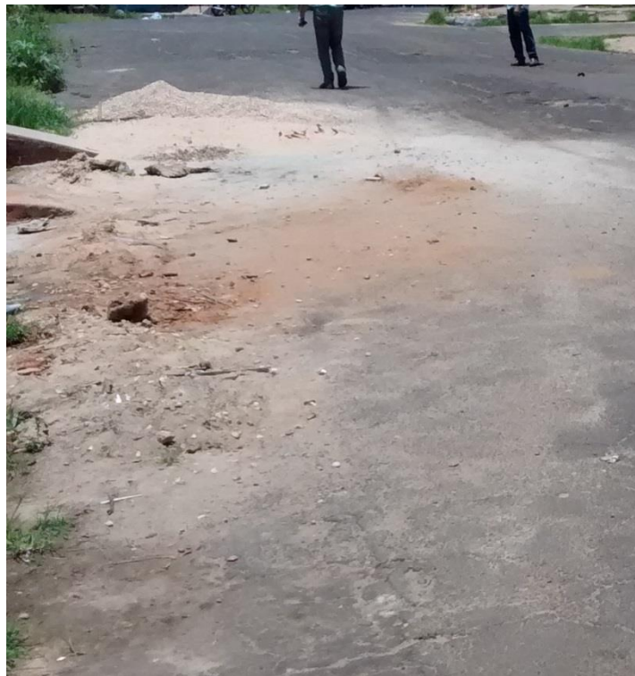
Figura 23: Dique do Poti – Muro de alteamento de crista interrompido / Cruzamento das ruas Domingos Jorge Velho e Cedro / Acesso ao Porto e Restaurante Pesqueirinho.
