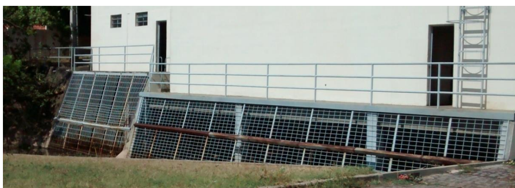
Figura 11: Elevatória dos Oleiros – Grades da tomada de água.
