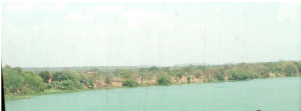
Figura 30: Dique do Poti – Jusante da ponte Mariano Gayoso Castelo Branco / Trecho de talude protegido com sacos de r fia preenchidos com cascalho e areia.
