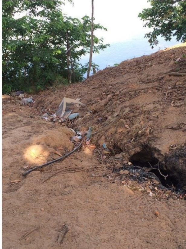
Figura 34: Dique do Parnaíba – evidências de formação de erosões
