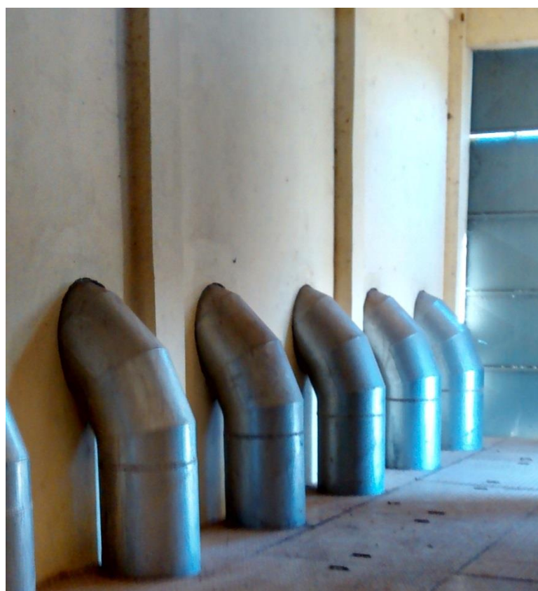
Figura 13: Elevatória dos Oleiros – Tubulações de recalque da ampliação (trecho interno à elevatória)
