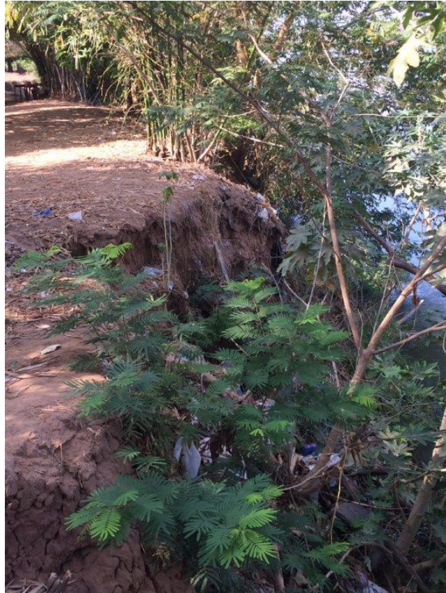
Figura 32: Dique do Parnaíba – Vista do talude junto ao rio, mostrando taludes íngremes.
