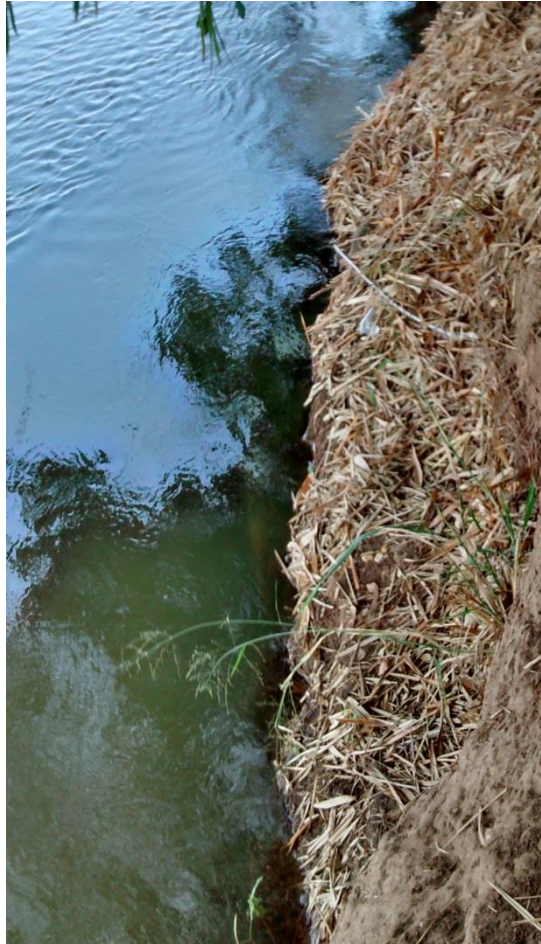
Figura 20: Rio Parnaíba – MD Parque do Encontro / Vista para jusante / Talude íngreme.
