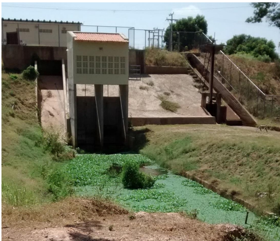
Figura 14: Elevatória dos Oleiros – Estruturas e canais de descarga no rio Parnaíba.
