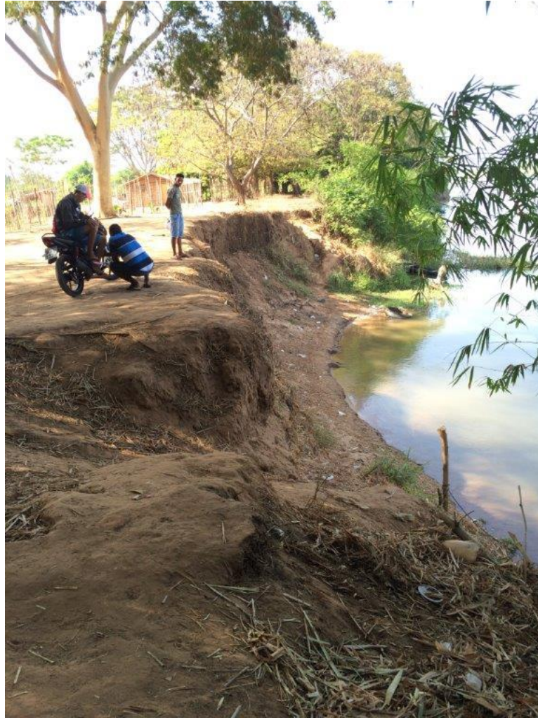
Figura 36: Dique do Parnaíba – evidências de formação de erosões
