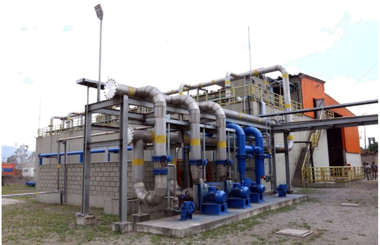
Figura 19 - Biodigestor Methanum em Operação na COMLURB - RJ
