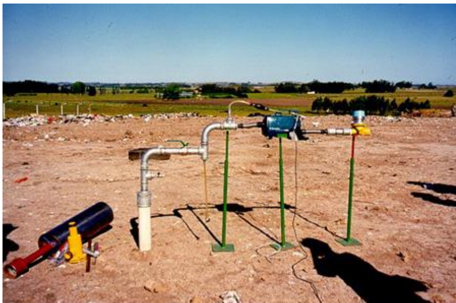
Figura 22 - Captação de Biogás em Aterro Sanitário.
