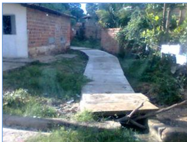
d) Vista de caixa de entrada e galeria pluvial no Bairro Buenos Aires, Zona Norte. Sub-bacia PE 26.
