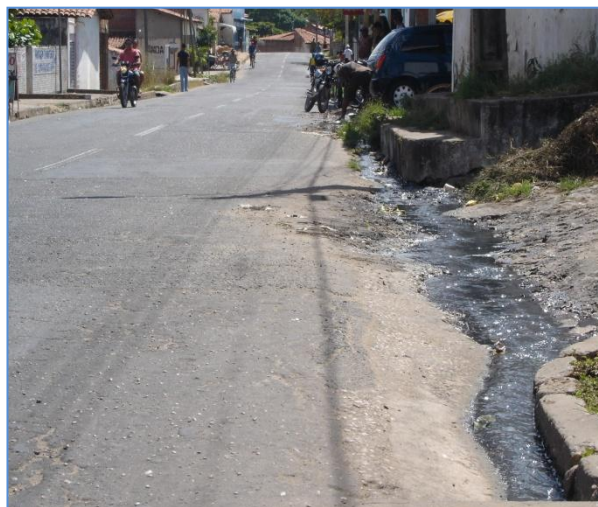
b) Rua Capitão Vanderley - Bairro Piçarreira - zona leste com água servida escoando pela sarjeta.
