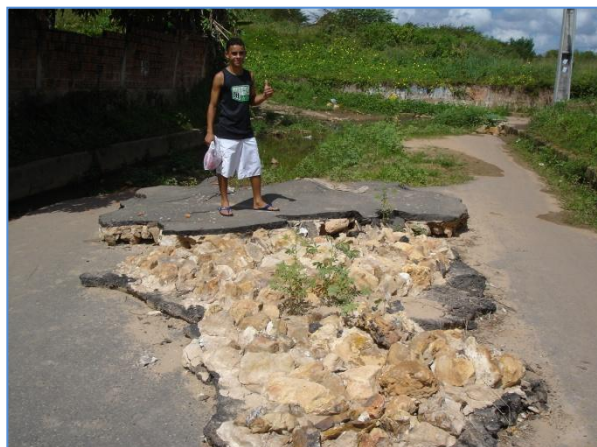
b) Na Rua Bela, o pavimento asfáltico foi carreado pela força das águas em excesso.
