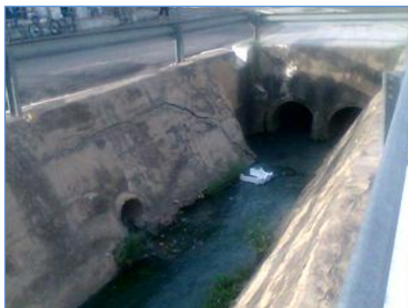
d) Galeria pluvial com água servida na Av. Freitas Neto na sub-bacia do Mocambinho, Zona Norte.
