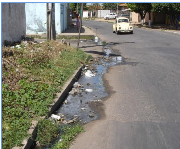
c) Os pontos baixos de sarjeta sem dispositivos de engolimento não acumulam somente água servida, lixo também - Rua Capitão Vanderley, esquina com Tio Bentes.
