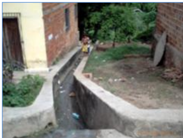
b) Canalização pluvial cercada de ocupações indevidas, Vila da Paz, Zona Sul. Sub-bacia PE 9.
