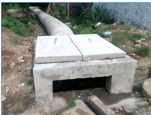
c) Vista parcial da rede pluvial no Bairro Porenquanto, Zona Norte. Sub-bacia PE 16.
