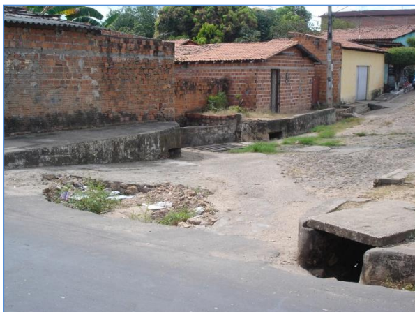
a) Cruzamento das Ruas Geovani Prado e Santa Quitéria, evidenciando estragos pelo excesso de águas pluviais sobre as ruas.
