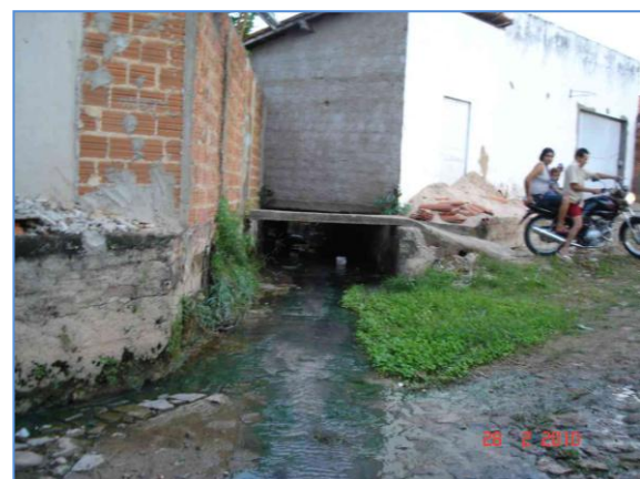
f) Vista de entrada de canal pluvial no Bairro Pedra Mole, Zona Norte. Sub-bacia PD 07.
