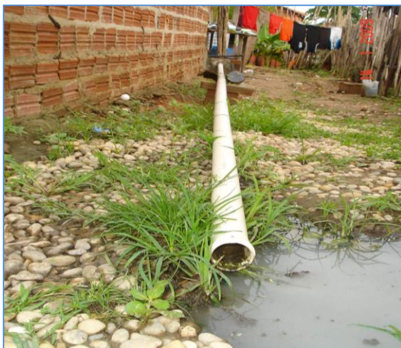
a) Derivação de água servida que não vai à fossa e acaba seguindo em direção às sarjetas. Bairro Morros - zona leste.
