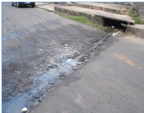
d) Rua Major Sebastião Saraiva mostrando típica “passagem molhada”, dispositivo muito comum na periferia que também comumente escoar esgoto.
