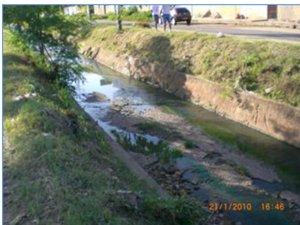
c) Galeria pluvial sem a devida manutenção na Av. Celso Pinheiro, Zona Sul. Sub-bacia PE 11.
