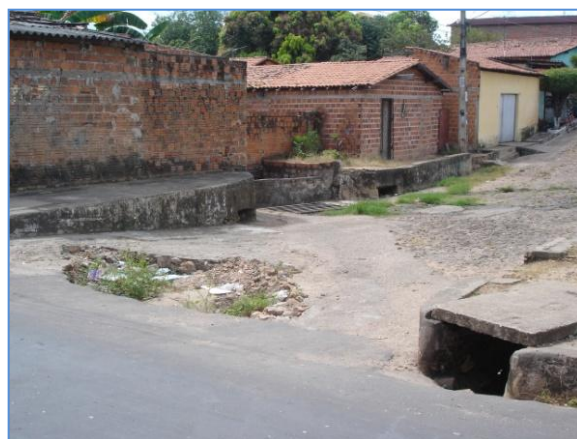
b) Rede pluvial e seus dispositivos precários, Bairro Satélite, Zona Leste. Sub-bacia PD 07.
