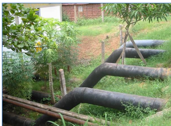
c) Tubulação da casa de bombas da Lagoa dos Oleiros.
