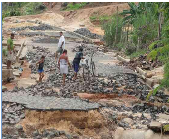
Figura 9.30. Rua Estômato próximo a esquina com Av. Goytacaz, na Vila Irmã Dulce: pavimento destruído pelas chuvas.
