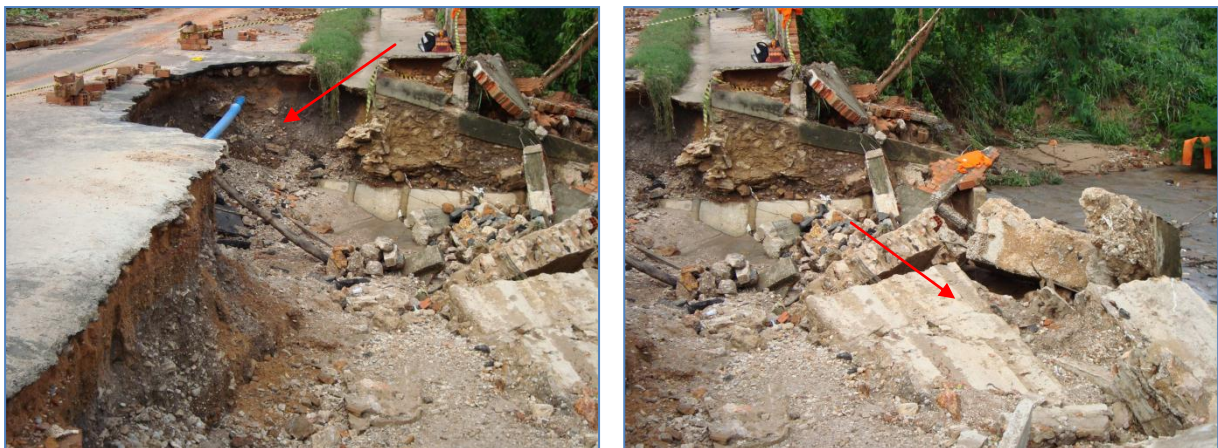
Figura 10.5. Rua Santa Efigênia: parte da pista e seu talude foram levados pelo escoamento pluvial, provocando ainda o colapso de um muro de arrimo.
