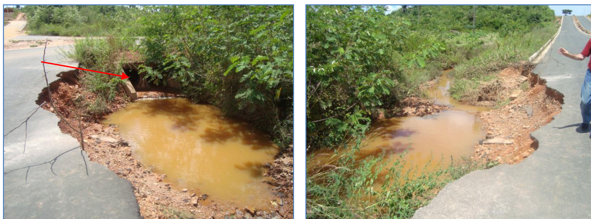
Figura 10.6. Avenida de acesso ao Residencial Mário Covas: vista da saída do dispositivo de drenagem e pista danificada.
