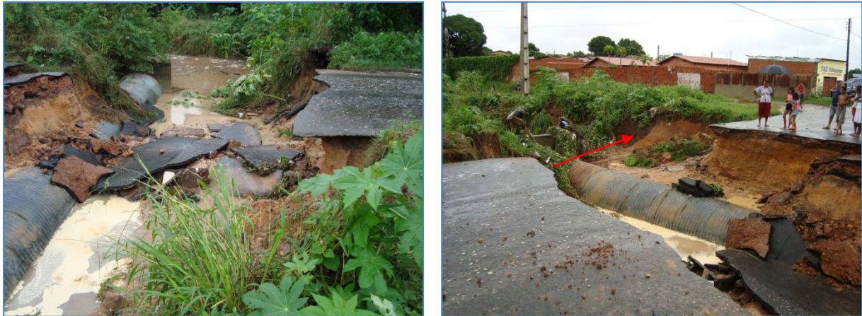
Figura 10.4. Bueiro rompido na Rua Celso Pinheiro próximo a Rua Chico Xavier: erosão em detalhe (à direita).
