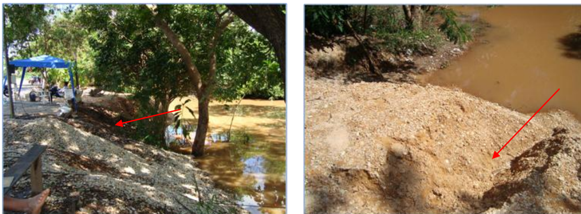
Figura 10.3. Bueiro rompido na Av. Maranhão próximo ao cruzamento com a Av. Gil Martins: erosão em detalhe (à direita).
